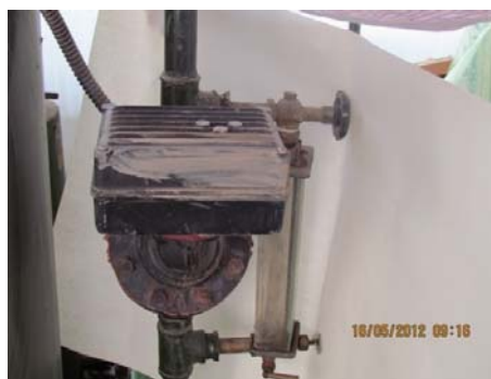
شکل ۳- شیر کنترل سطح آب در مخزن
