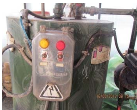
شکل ۴- تابلو برق و سیستم راه انداز
